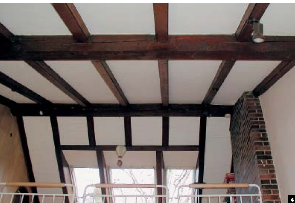
Abb. 4: In diesem Altbau fand sich biozidbelastetes Balkenholz (PCP, Lindan).
