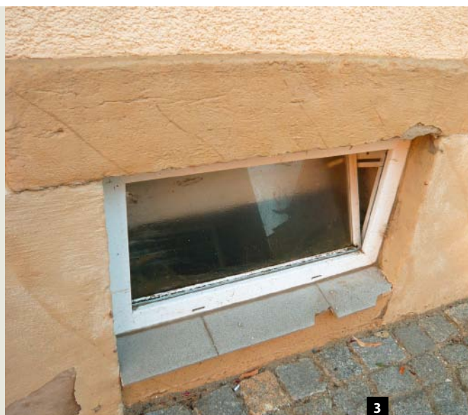
Abb. 3: Gekippte Fenster eignen sich kaum, um durchfeuchtetes Mauerwerk schnell zu trocknen.
