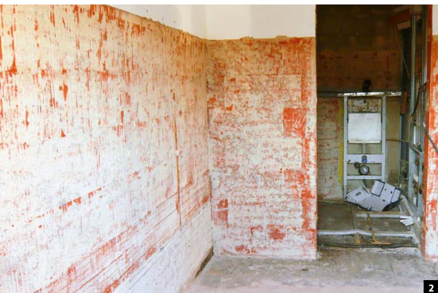
Abb. 1: Nach Abfließen des Hochwassers wird der durchfeuchtete Gebäudesockel sichtbar.
